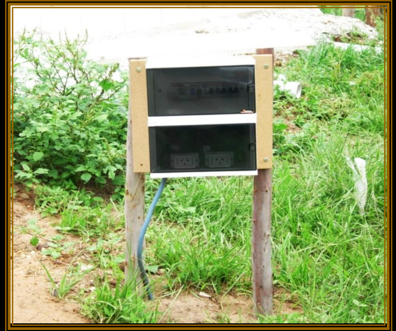
Conexión de electricidad
